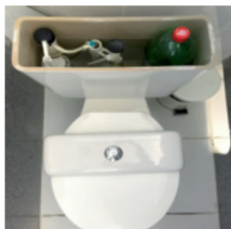
Figure 3: Toilet flush box. © N. B. Cardoso.
