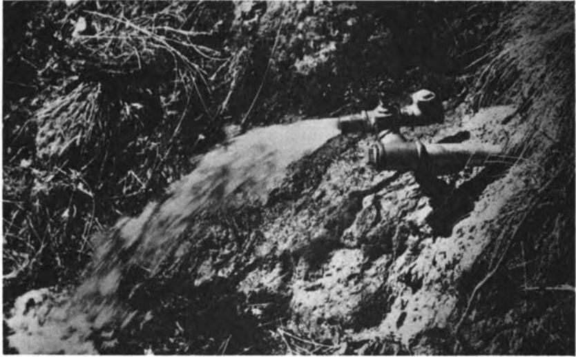
FIGURE 37 Un puits horizontal, mis à l'essai, débite plus de 200 l/min. La tuyauterie comporte deux conduites d'alimentation, un clapet de sécurité et un raccord de réduction. (W. T. Welchert)
