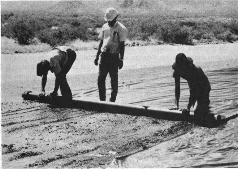
FIGURE 9 Pose d'une feuille de polyéthylène sur un bassin dans le désert de Sonora, Arizona (Etats-Unis). Le polyéthylène est ensuite recouvert de gravier pour assurer la protection contre les détériorations et le rayonnement solaire. (C. B. Cluff)
