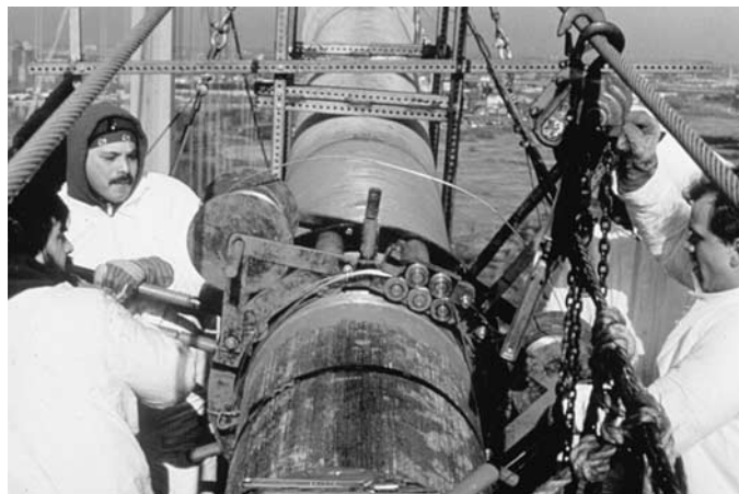
Figure 2.3.1.3.2.c-2. Manual wrapping machine.
