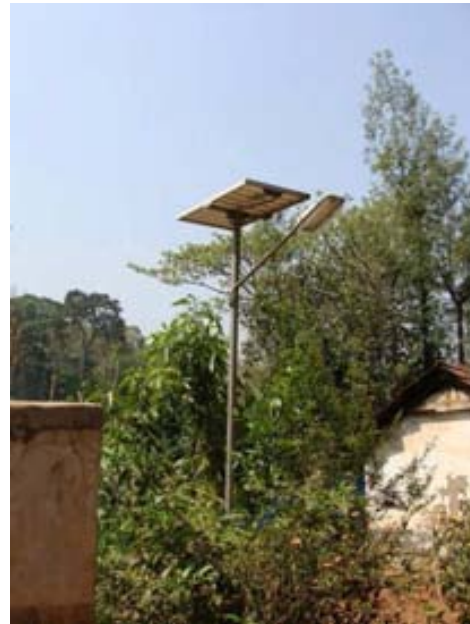
Figura anexo 2.13 Infraestructura de electricidad solar (sin funcionamiento) en Kodagu (Karnataka, India).
