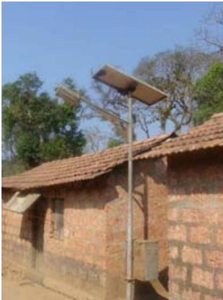
Figura anexo 2.12 Infraestructura de electricidad solar (sin funcionamiento) en Kodagu (Karnataka, India).
